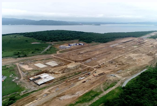
Перевалочный комплекс СУГ АО «СГ-транс» в морском порту «Суходол» Заказчик: АО «СГ-транс»
